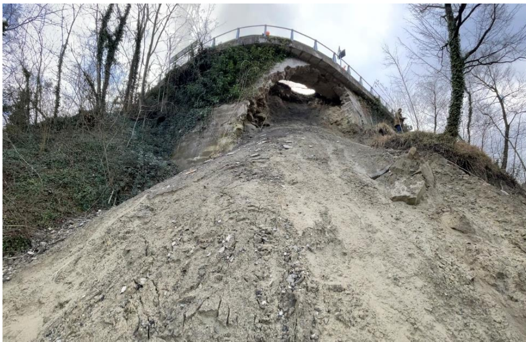
Figura 2 - Tratto di dissesto della sede stradale
