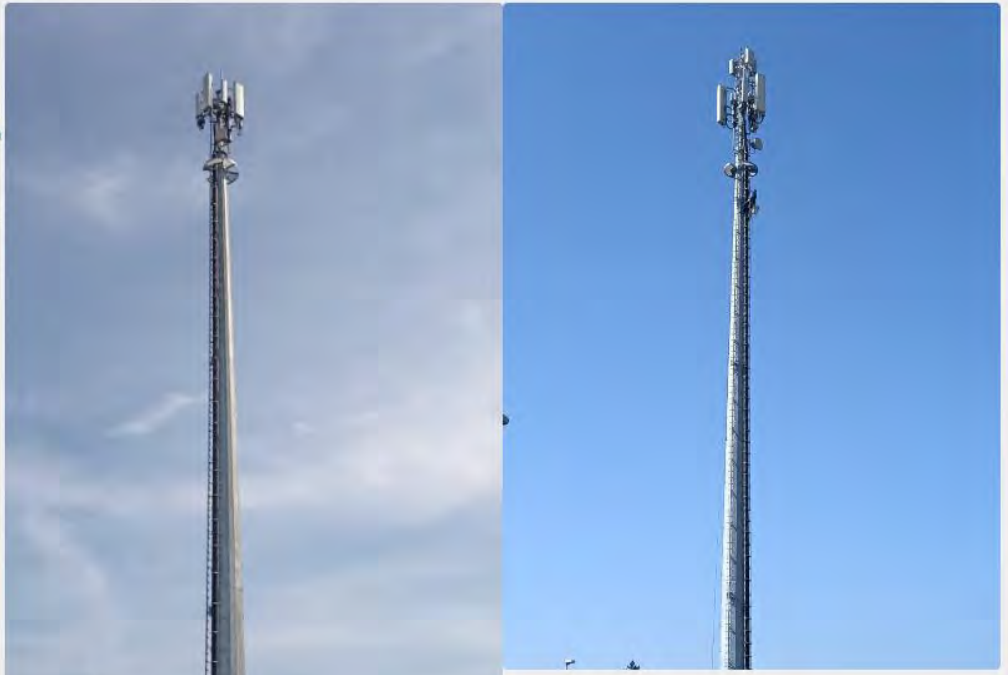
Fig. 5.7.1.8 - Ubicazione degli impianti SRB a sud di San Giovanni in Persiceto
