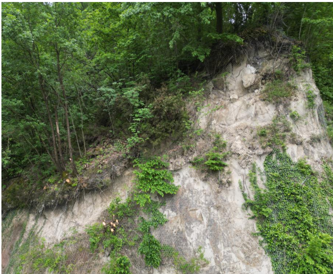
Figura 7-10. Ripresa aerea frontale della “prua” presente al limite ovest dell’area denominata A_004. Si noti l’intensa fratturazione a carico delle porzioni di ammasso roccioso più prossime al ciglio. Questa ha determinato il distacco di blocchi trattenuti dal rafforzamento esistente. La presenza di apparati in crescita all’interno delle fratture, ne promuove l’apertura e può costituire un meccanismo di innesco di distacchi a seguito dell’oscillazione degli alberi esposti all’azione del vento. Si noti come, nonostante gli sfalci eseguiti, la coltre vegetata in aggetto sulla parete rocciosa, ne impedisca parzialmente l’ispezione.
