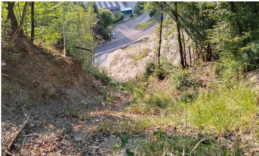
Figura 7-40. Vista dall'alto dello sbocco del canale che ospita presso l'area denominata M_014 verso la scarpata riprofilata sottostante. Qui gli eventi del 2023 (come plausibilmente quelli del 2024), hanno apparentemente mobilitato un'aliquota maggiore del materiale presente lungo il fondo canale. Si noti anche il fianco sinistro eroso.
