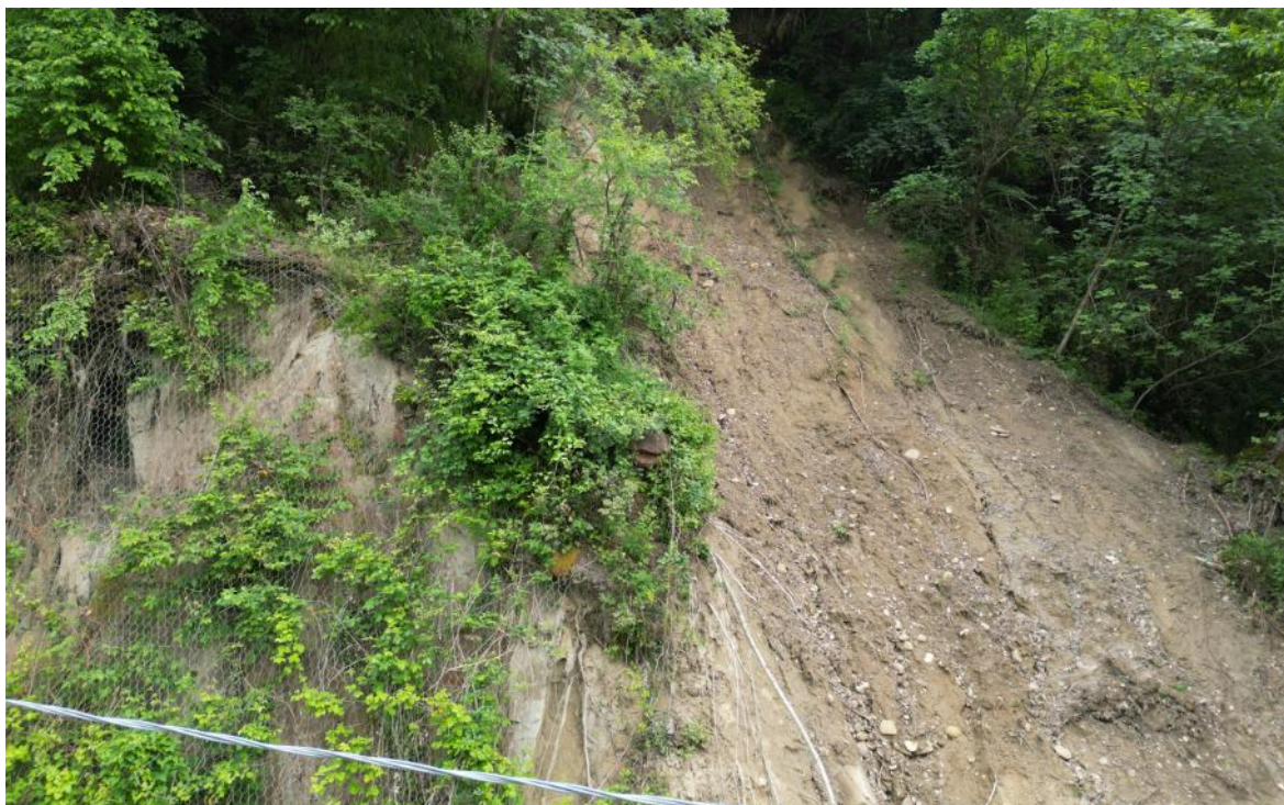
Figura 7-5. Ripresa dell'area denominata A_002 (sulla destra) e dell'area A_003 (sulla sinistra). La prima è soggetta all'instabilità di coltri che ha causato lo scivolamento delle stesse nel 2024. Presso la seconda possono verificarsi sia distacchi di blocchi dal fronte roccioso che instabilizzazione delle corti in testa alla scarpata e trattenute dalla rete metallica presente.
