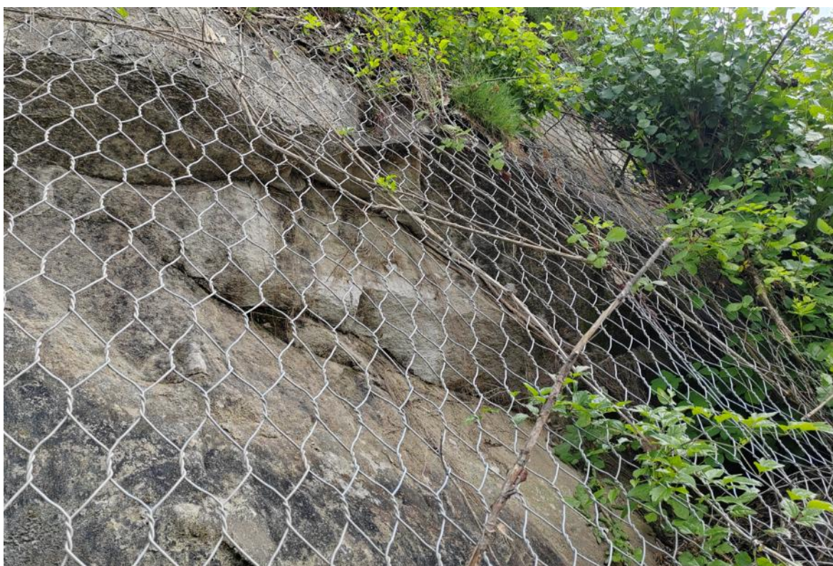
Figura 7-11. Vista complessiva e di dettaglio dell'area denominata A_015, presso la quale si riconoscono discontinuità a franapoggio molto persistenti. Queste appaiono attualmente serrate o aperte per pochi mm, ma la forte tendenza all'alterazione della roccia (specie se esposta agli agenti atmosferici o alla circolazione di acqua lungo superfici preferenziali) favorisce il decadimento delle resistenze lungo le pareti dei giunti. Non si può pertanto escludere un'evoluzione verso l'instabilità nel medio termine.
