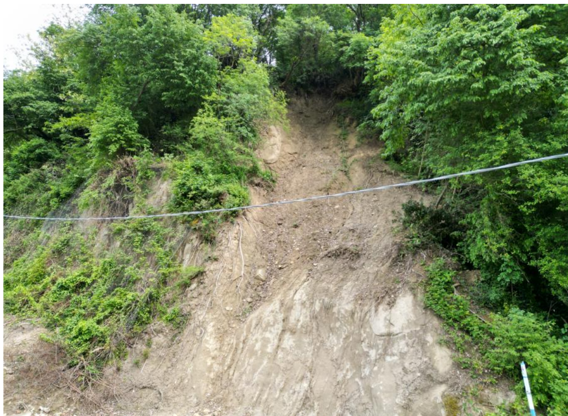
Figura 3-8. Vista frontale della frana per scivolamento occorsa durante gli eventi alluvionali del settembre-ottobre 2024, immediatamente a nord-est dell'attraversamento del Rio Ca' Nova, nella porzione settentrionale del sito di Allocco.
