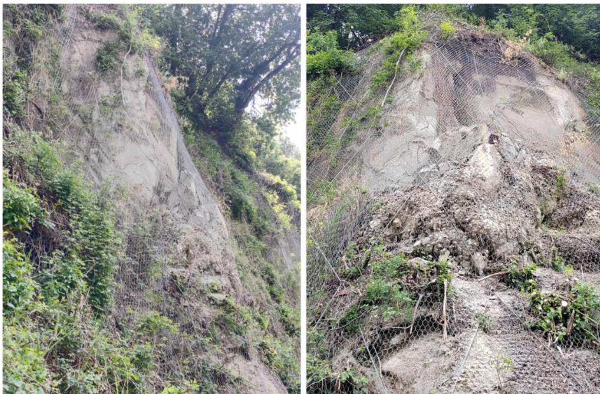
Figura 7-9. Vista laterale e frontale dell'area denominata A_011. Qui la scarpata costituisce una sorta di "prua" nella porzione superiore che determina un detensionamento marcato su 3 lati. Sistemi di fratture (o di superfici di debolezza) hanno definito volumi rocciosi unitari fino ad oltre 1 m 3 , attualmente trattenuti dalla rete e dalle funi nel rafforzamento corticale esistente, che versa pertanto in condizioni estremamente precarie. Una vasta porzione (diversi metri cubi) di roccia è isolata da fratture benanti e si presenta prossima al ribaltamento. La rete, inoltre, risulta piena di materiale ricunducibile a distacchi "minori" e al disfacimento della roccia alterata, dunque ulteriormente in tiro.
