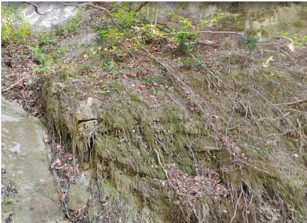
Figura 7-16. Dettaglio di un accumulo di coltri poggianti sul substrato lungo il fianco di un'incisione. In corrispondenza del fondo canale, dove il flusso superficiale che si instaura in occasione delle precipitazioni può raggiungere portate significative, si possono notare i segni dell'erosione e scalzamento del piede del deposito da parte delle acque superficiali.
