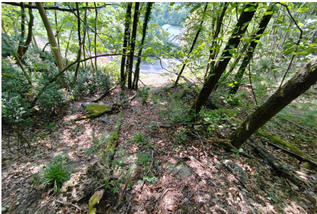
Figura 7-36. Vista dall'alto del ciglio della corona della frana del maggio 2023 ripresa presso l'area denominata M_002. Si noti il salto morfologico che testimonia la mancanza di sostegno al piede di tali spessori.
