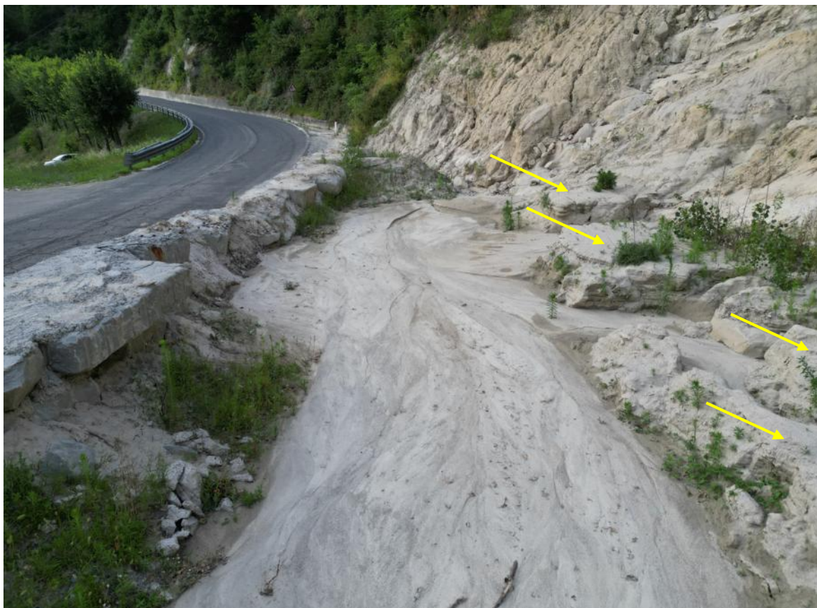
Figura 7-35. Riempimento del bacino a tergo del muro in faldoni con depositi sabbiosi prodotti dall'erosione della scarpata di frana/riprofilata. Il bacino è stato ragionevolmente già stato più volte svuotato, come sembrano testimoniare i depositi "terrazzati" al piede della scarpata (freccie gialle).
