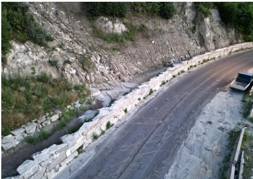
Figura 7-27. Vista laterale del piede della scarpata e del muro in faldoni lapidei. Si notino l'irregolarità del muro lato monte, che ostacola le operazioni di pulizia degli accumuli a tergo dello stesso e gli evidenti solchi erosivi.
