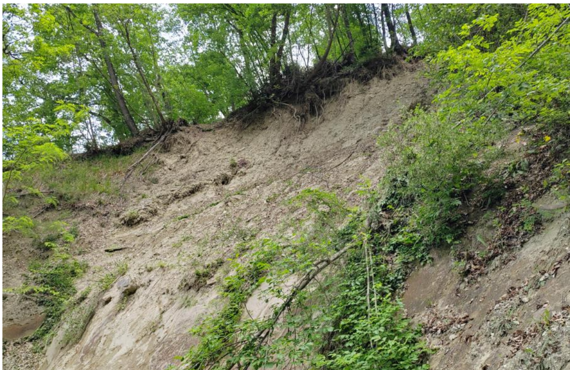
Figura 7-7. Dettaglio di una superficie di frana per scivolamento, poi evolutasi in colata (A_006), ricadente nell'area instabile denominata A_007 (Figura 7-2), in testa all'incisione a sud-ovest del Rio Ancini. Si nota la roccia denudata che ha funto da superficie di scivolamento e la presenza di materiale sciolto (coltre) ancora sospeso in testa alla scarpata.
