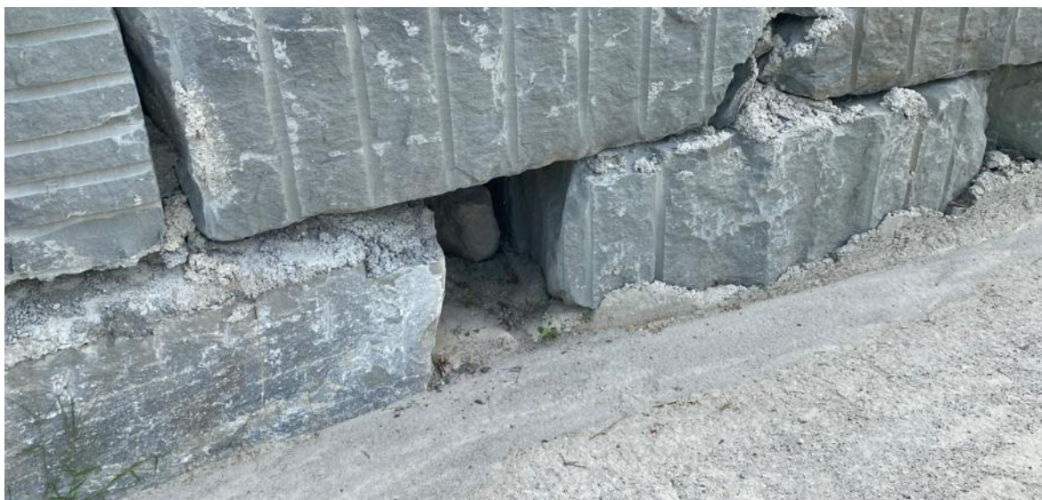
Figura 7-25. Dettaglio delli varchi lasciati tra i faldoni al piede del muro di contenimento realizzato successivamente all'alluvione 2023. Questi riversano gran quantità di sabbia lungo la cunetta alla francese, con conseguente invasione della sede stradale.
