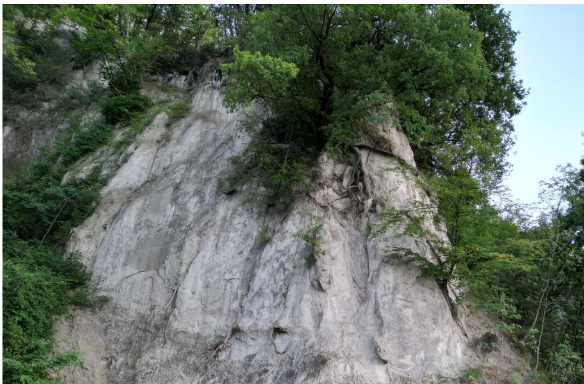
Figura 7-28. L’evidente sperone roccioso presente tra il bacino n°6 e n°7, in affaccio quasi diretto sulla SP 325. Lo sperone costituisce in testa una sorta di “prua” libera su 3 lati e pertanto particolarmente soggetta a dentensionamento. Ciò si traduce nella presenza di fratture subverticali, all’interno delle quali si sviluppano apparati radicali che con la loro crescita promuovono l’apertura delle discontinuità, predisponendo o addirittura innescando potenziali distacchi.
