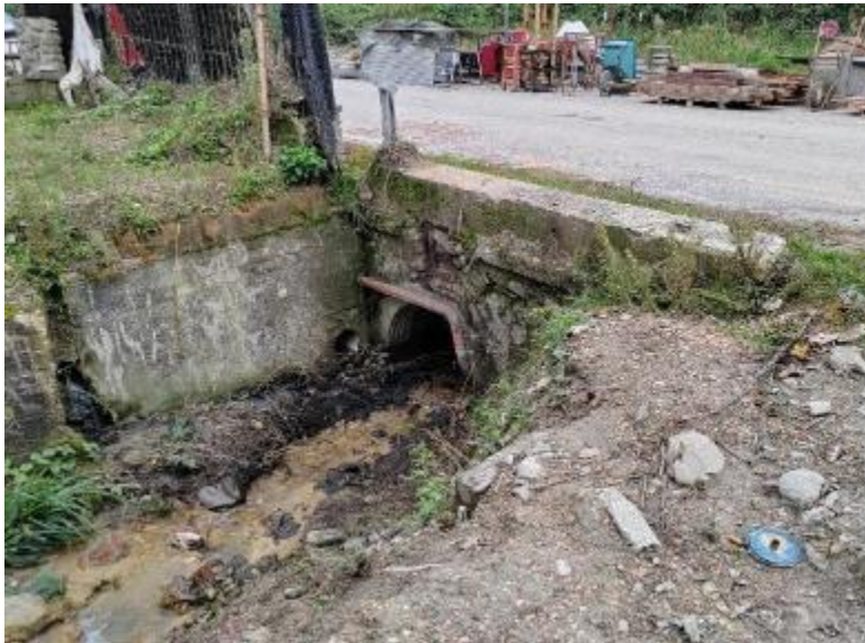
Figura 7-9: Imbocco attraversamento idraulico della SP325 del Rio Ancini post eventi alluvionali del 2023/24
