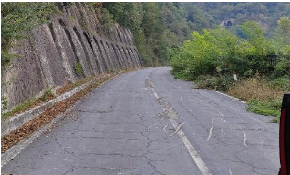
Figura 7-7: Fessure pavimentazione esistente
