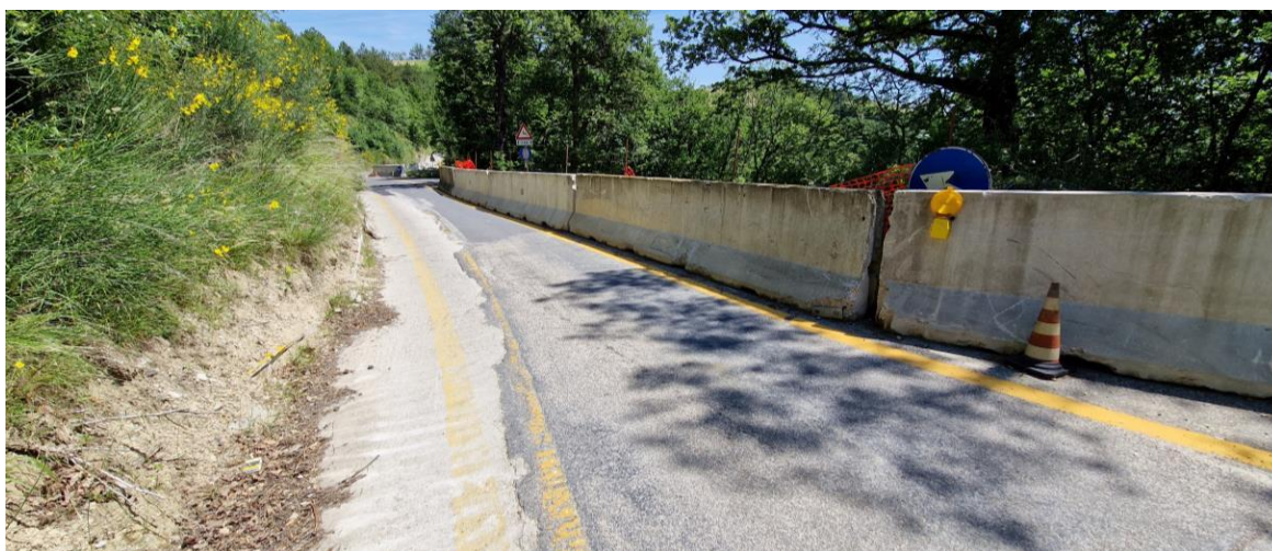
Figura 21: Foto 2: Riduzione carreggiata causa frana al km 0+200
