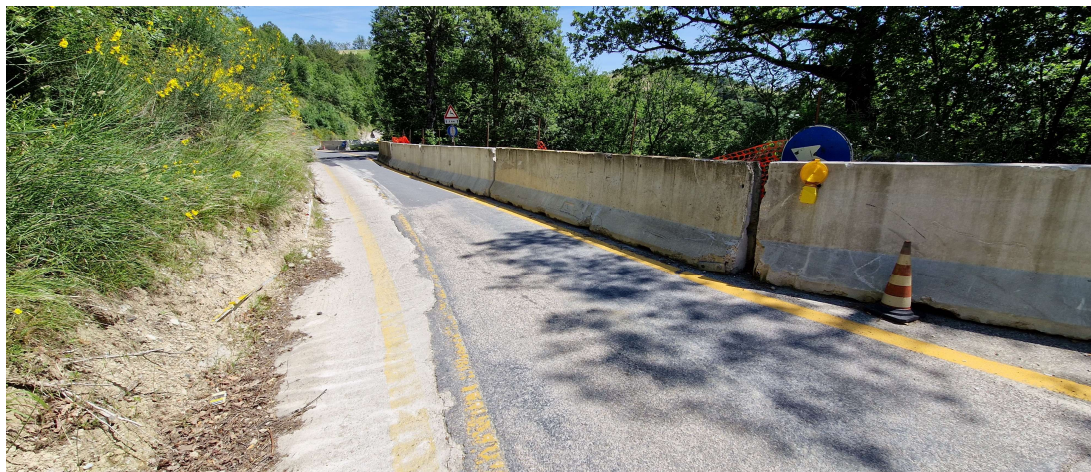
Figura 6: Riduzione carreggiata causa frana al km 0+200
