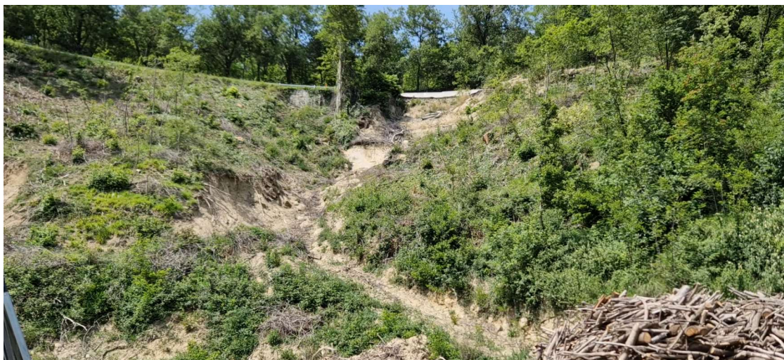
Figura 7 Vista di uno dei crolli dalla base
