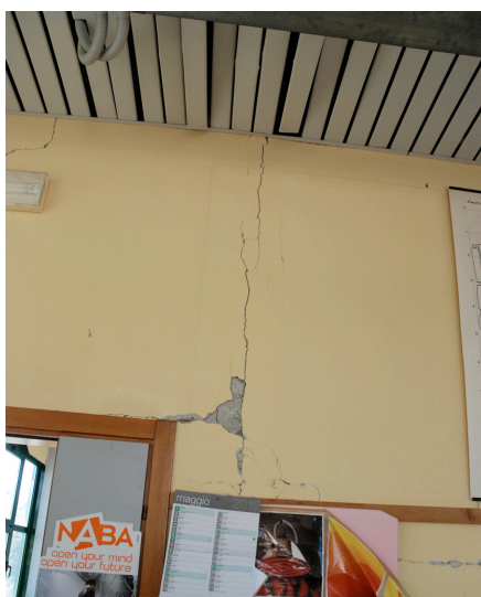
1.d Presenza di lesioni pareti e deterioramenti delle parti presenti in copertura;
