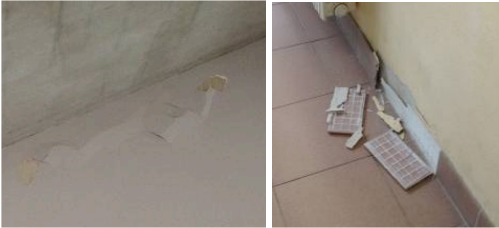
1.f Presenza di lievi danneggiamenti di nodi pilastro trave causati dall'isostaticità della struttura stessa.
