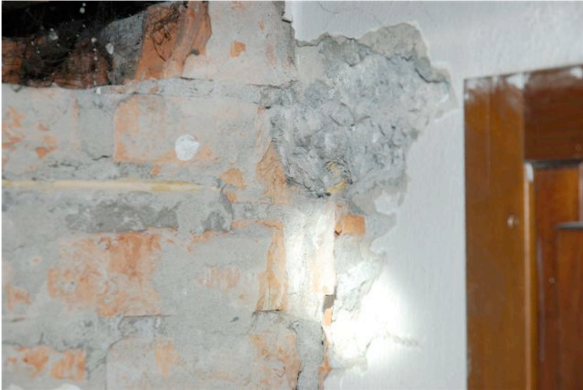
Figura n.8 –Evidente tinta presente sotto l'intonaco su parete interna
