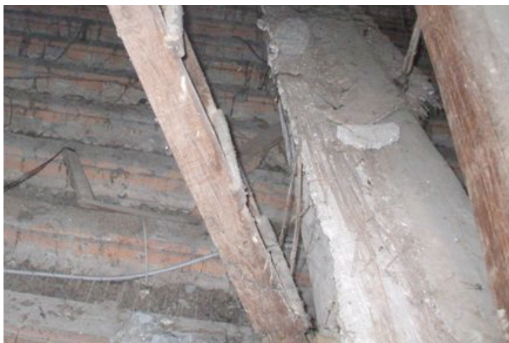
Figura n.6 –Tracce sotto le catene delle capriate dei precedenti arellati
