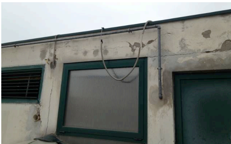
1.e Presenza di distacchi di battiscopa ed intonaci;
