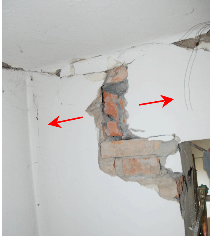
1.18 presenza muratura forata al piano primo allineata alla muratura portante a sostegno dell'impalcato in latero-cemento del sottotetto
