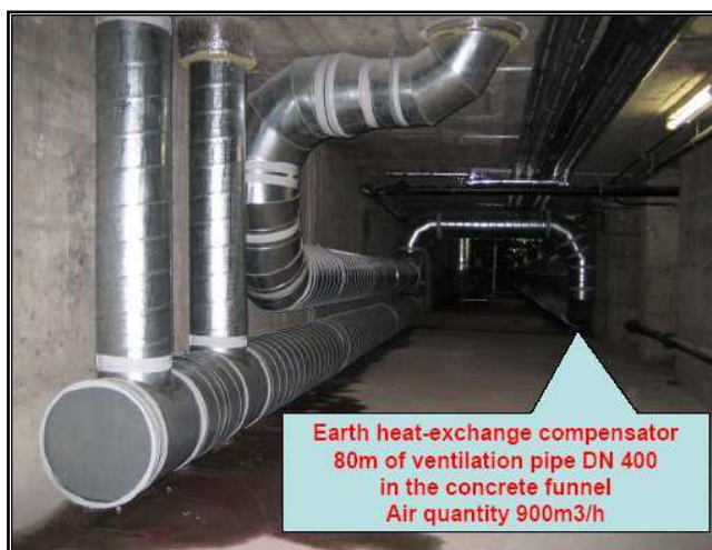
Fig. 33 stabilimento Drexel & Weiss a Wolfurt (Austria) – le tubazioni dell'impianto a pozzo a canadese.
