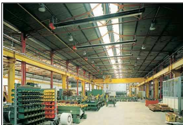
Fig. 21 – riscaldamento con moduli a tubi radianti in uno stabilimento industriale; i singoli elementi possono essere accesi con la stessa semplicità di una luce elettrica e sono particolarmente indicati per il riscaldamento a zone differenziate. Immagine tratta dal sito www.edilportale.com .
