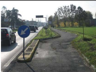
Situazione degradata, manca la segnaletica, verticale ed orizzontale e l'erba invade la pista
