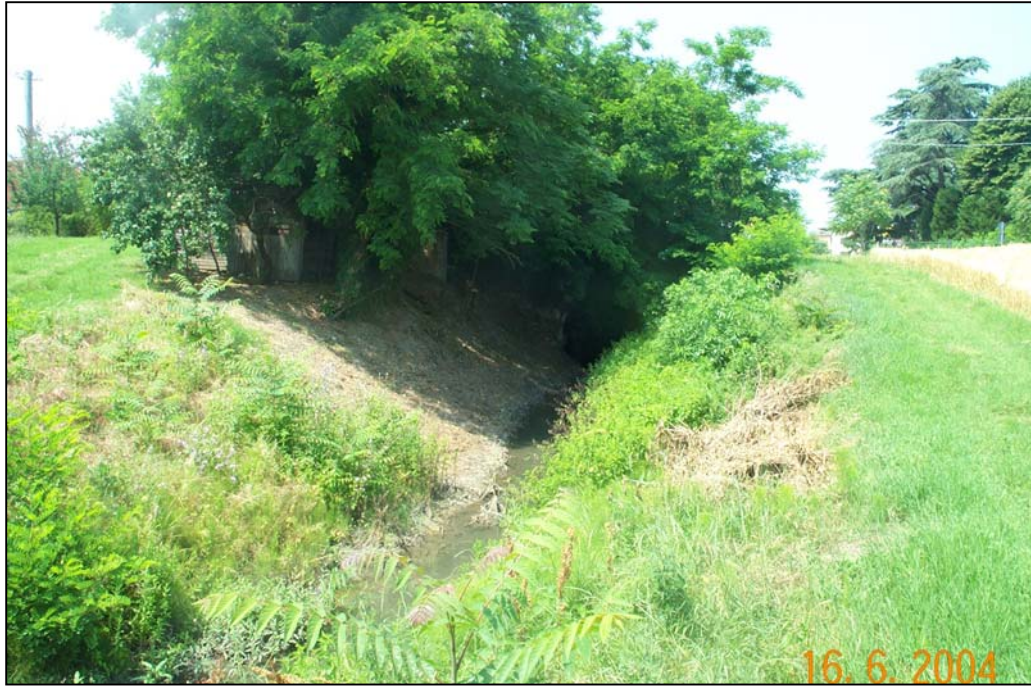
foto n. 7 - Un'immagine del Canale all'uscita del tombamento di Castel san Pietro Terme
