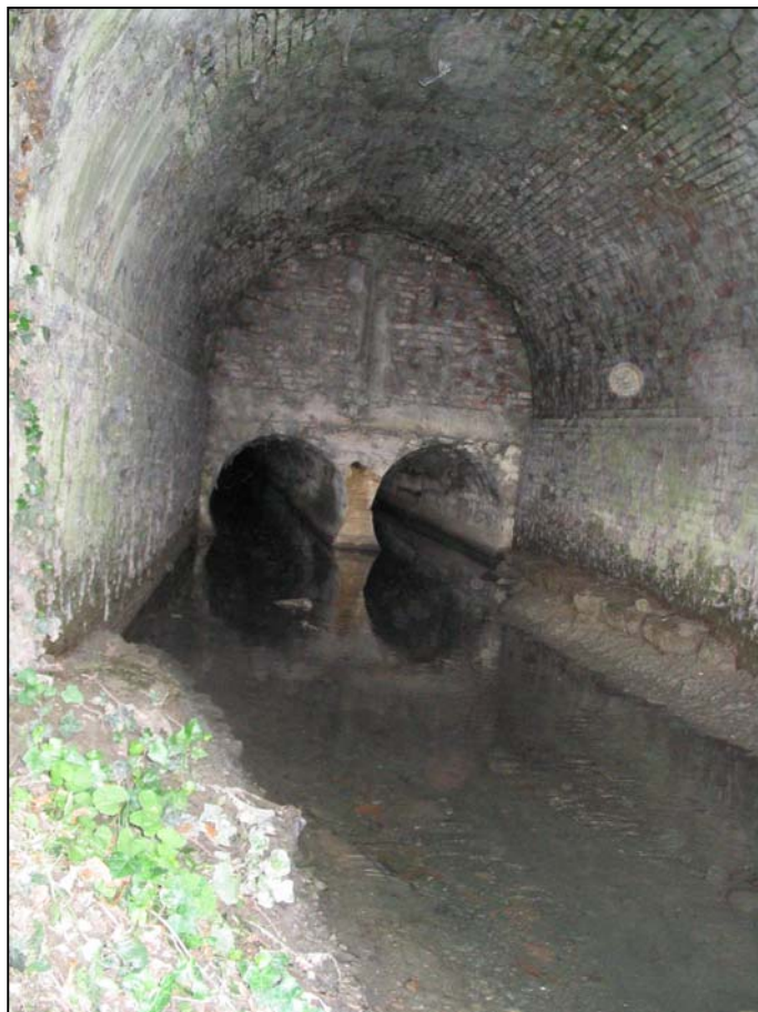
foto n. 8 – La doppia canalizzazione visibile all'uscita del tombamento presumibilmente risalente al 1800: la struttura è in mattoni di forma circolare
